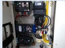
電子ブレーカー設置 (12物件導入済)
