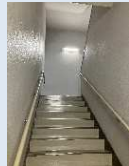
人感センサー 階段照明 (池下ESビル)
