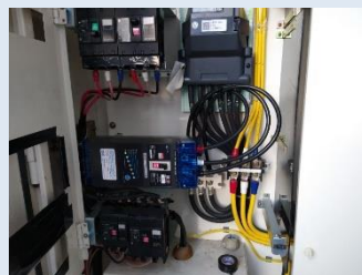
電子ブレーカー設置 （7物件導入済み）
